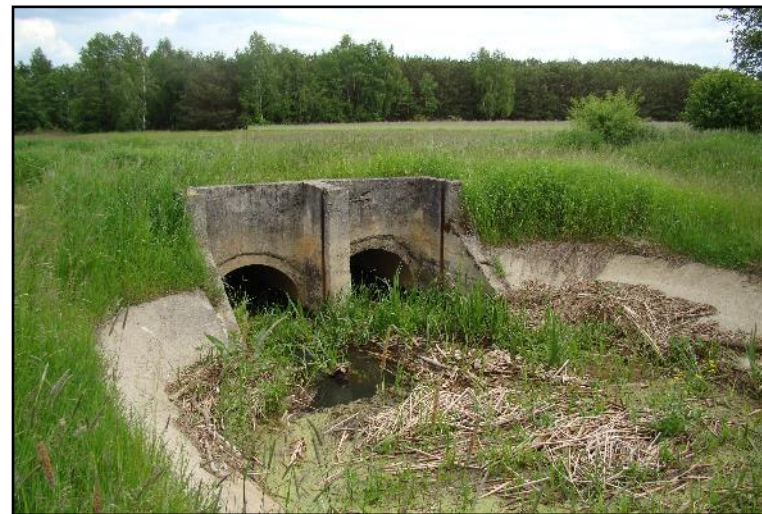
Fot. 23 Most na Lutni przy północnej granicy gminy, widać brak elementów zastawki i zarastanie roślinnością
