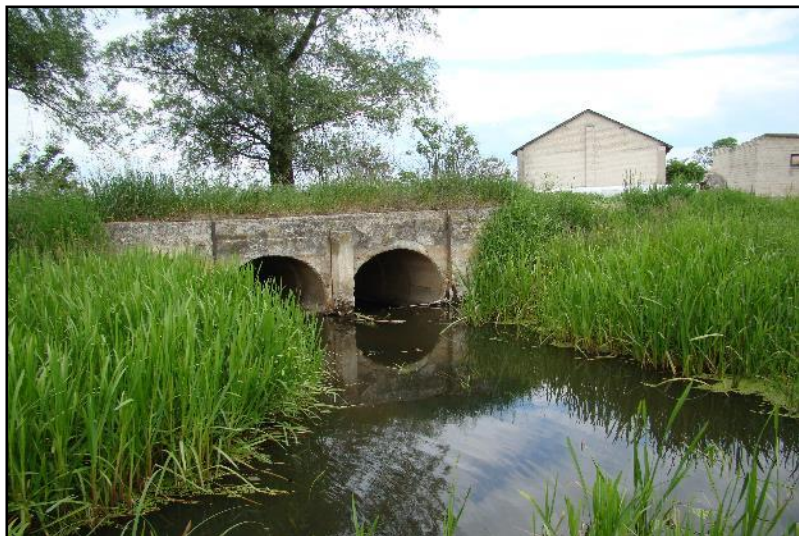
Fot. 21 Most na Lutni w Koszółkach, elementów zastawek brak
